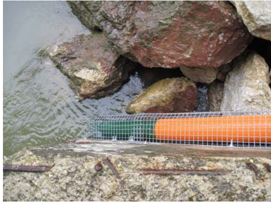
Figura 3 – Particolare del sistema di prelievo
